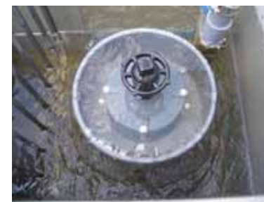
普通期は逆流防止柵を取付ける
