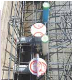
洗面所、洗濯機の排水用に設置されたPack75
