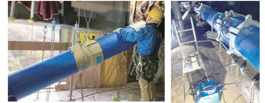
1階の足場から2階の足場へ吊り上げられる水道配水用ポリエチレン管
