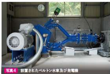
写真4 設置されたペルトン水車及び発電機
