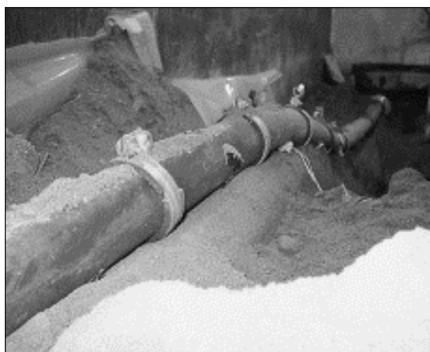
50cm 沈下時の管路変形状況
