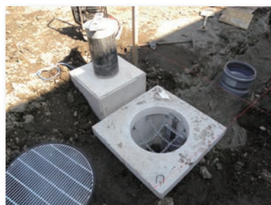
洗浄ユニット貯水槽と井戸
