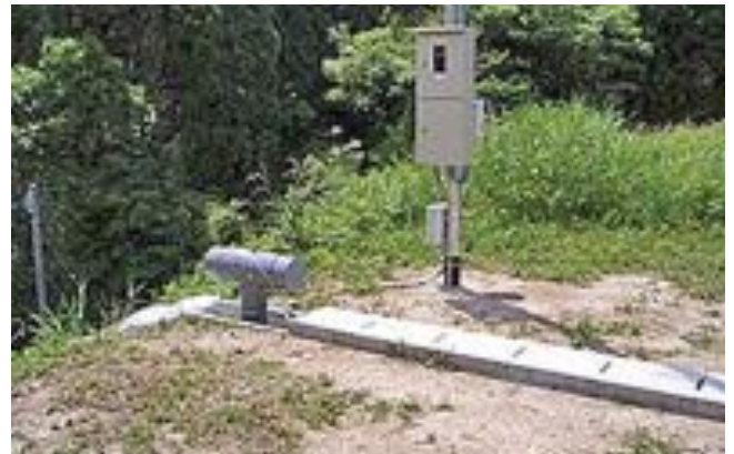
制御盤と気体捕捉タンク
