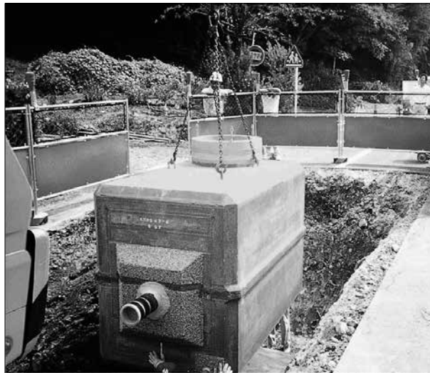
配管組込みタイプ吊り下し
