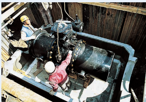
分割タイプ(現場配管)パタフライ弁室
