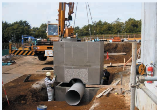
分割タイプ(現場配管)電磁流量計室
