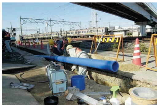
軌道付近(電食対策)
