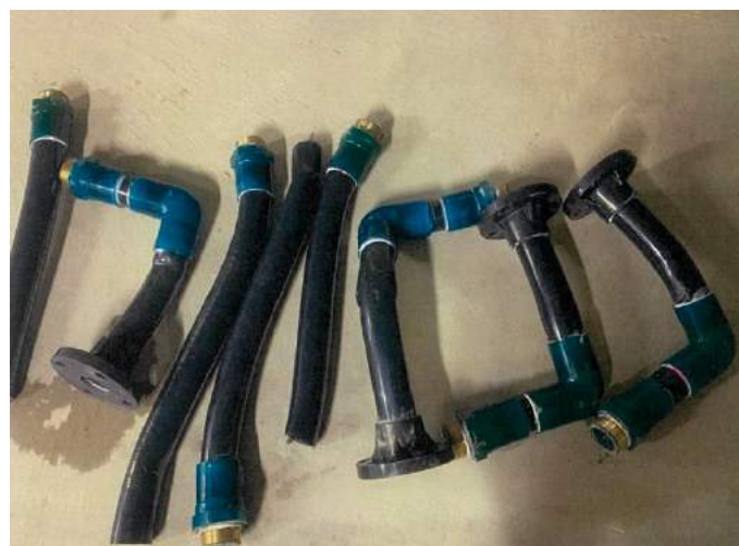
水温上昇によってポンプ付近の管が変形した。
