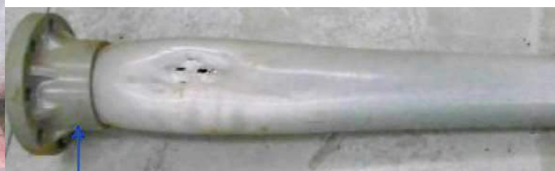
水温上昇によって管が膨張し、漏水事故が発生した。
