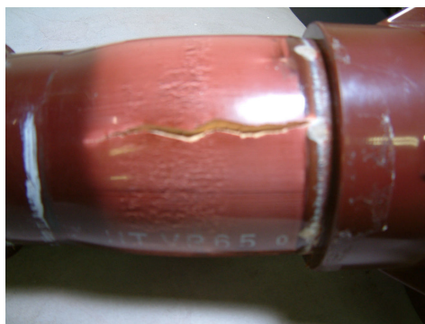
許容値を超えた高温流体が HT 管内を通過した膨張破裂事故例
